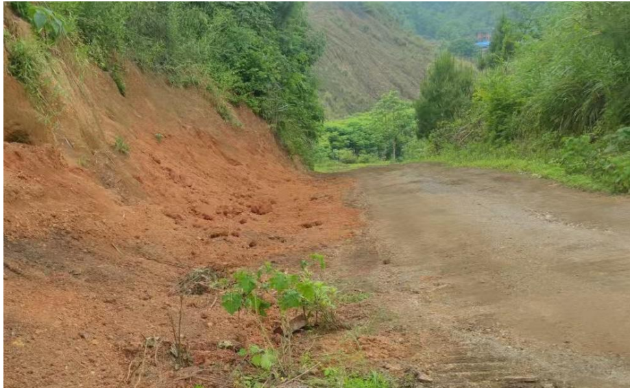
插图4.1-4 矿山公路占损现状
