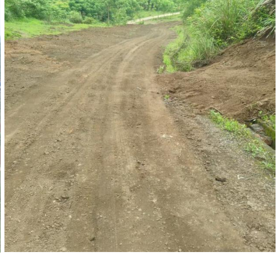
矿山公路占损
