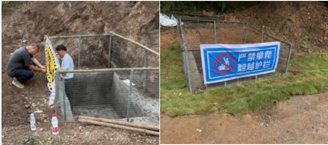
沉砂池及安全围栏
